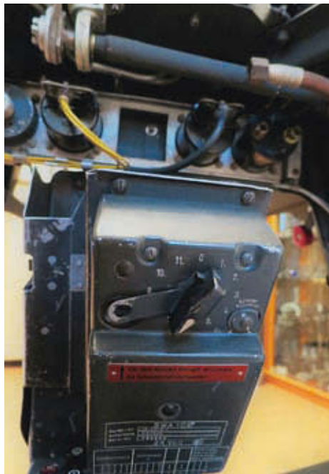
Schaltkasten SWA 10 hinter der Mittelkonsole Foto Privatsammlung
