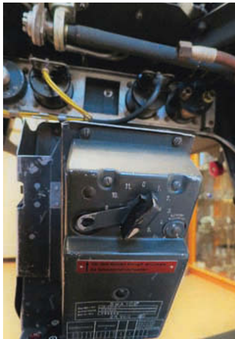
Schaltkasten SWA 10 hinter der Mittelkonsole Foto Privatsammlung
